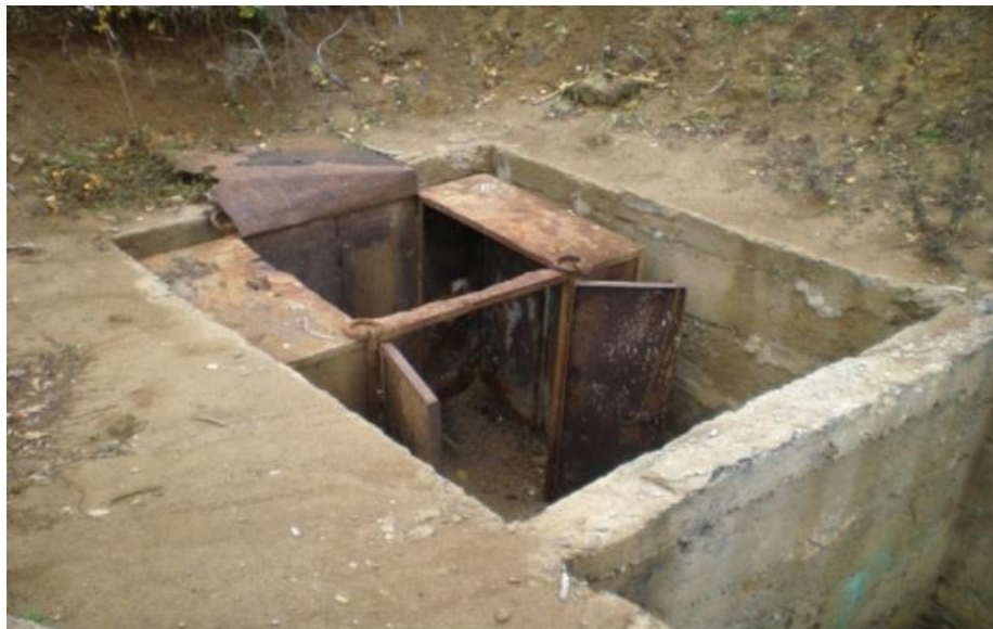
Рис. 4. Металеві контейнери Джури́нського отрутомогильника в яких зберігалися ртутьвмісні сполуки
