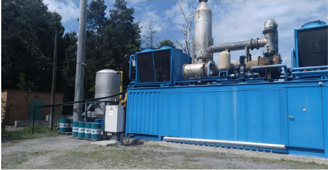
Рис. 4. Станція збору метану на Стадницькому полігоні
